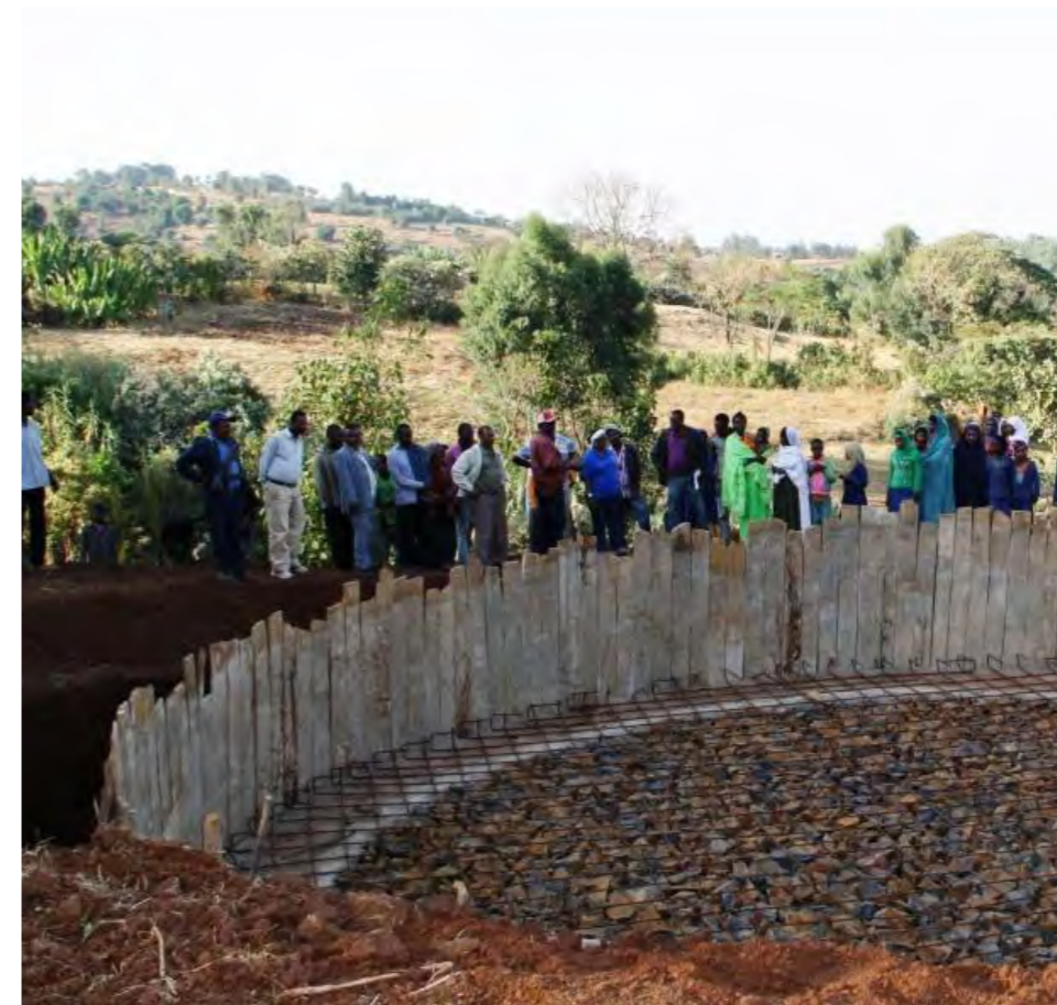
Das neue Nachtspeicherbecken wird einmal 124 Kubikmeter Wasser für die Bewässerung der Felder speichern.
